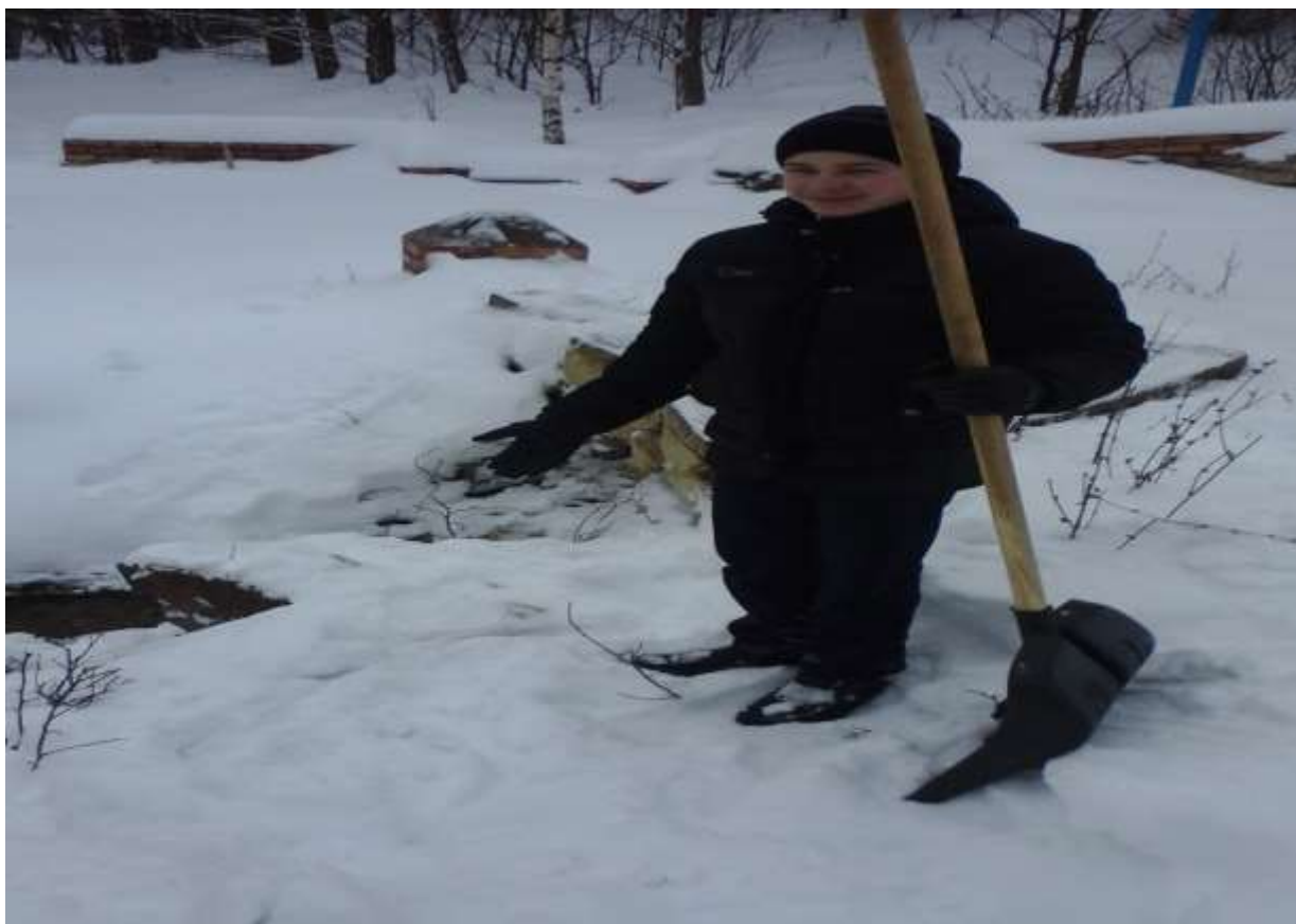
Водоотводный желоб требует восстановления.
